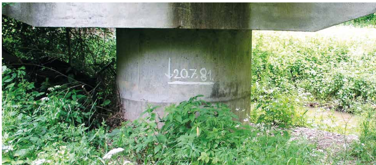
Obr. 13. Vyznačení hladiny Rakovnického potoka za povodně 20. července 1981 na železničním mostě u Pustovět (foto a archiv L. Kašpárka)
